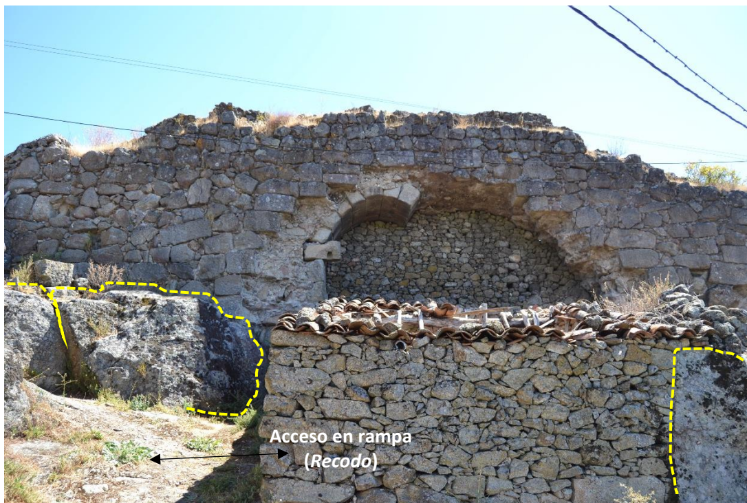
Vivienda antes de su retirada. Afloramientos de roca madre. Rampa de acceso en recodo.
